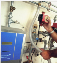
Kvalitetsligningen skaber til cirkulationsledningen ved pumpen. Herefter renses ydes alle stikstrøme en efter en.
