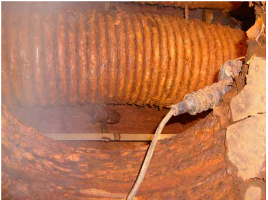
En varmtvandsbeholder før rensning. Efter rensning blev spiralen konstateret utæt på grund af tæringer. Overslagspris for dette arbejde: ca. 30.000 kr. Foto: R. Neubert & Søn A/S
